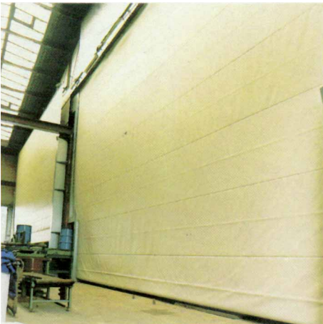
Hier gab es Wärme- und Zugluftprobleme
